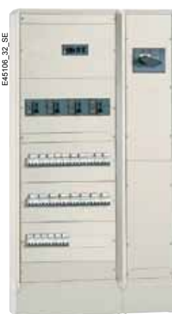
Промежуточный распределительный щит
